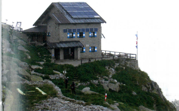
Al Rifugio Carè Alto 'D. Ongari' sono in corso i lavori per la nuova centralina
